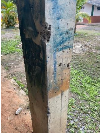
Gráfica 05: Patologías en columnas
