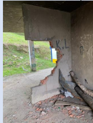
Gráfica 08: Muros derrumbados parcialmente
